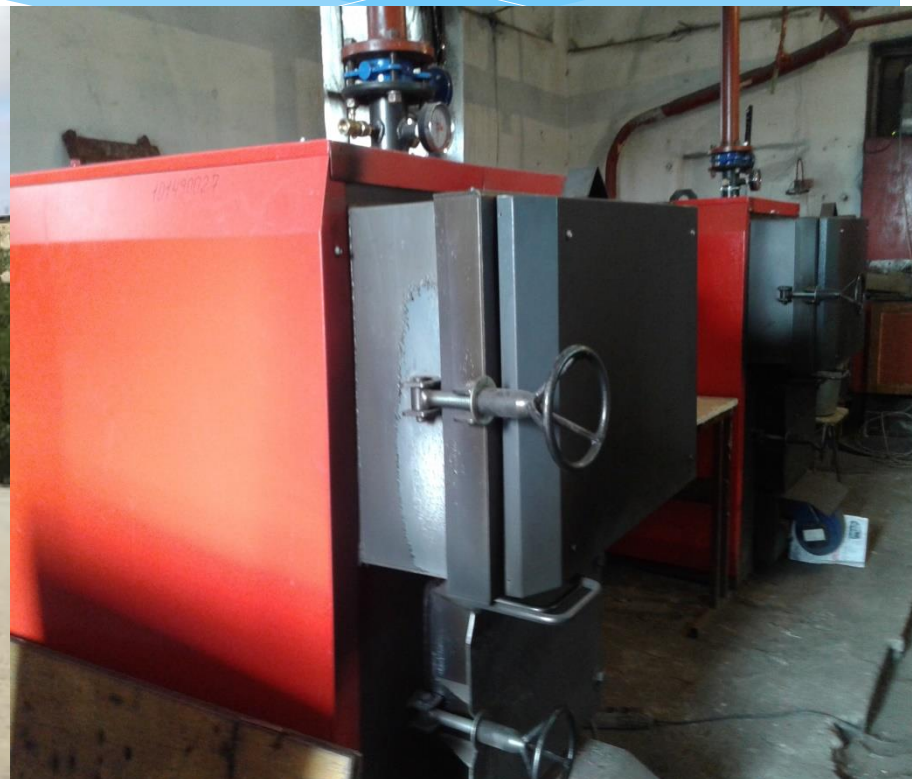
Верхньокриничанський НВК придбання котлів на твердому паливі
